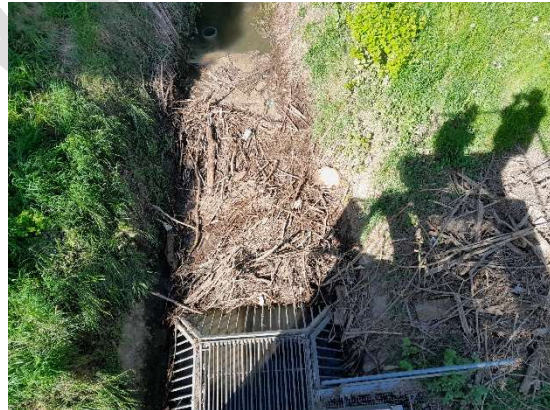
Abbildung 15 Notwendige Beräumung des Einlaufrechens am HRB Eselsgraben
