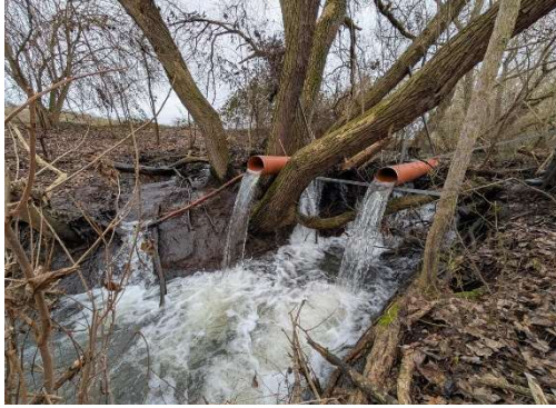
Abbildung 12 Drainageleitung zur Absenkung des Wasserstandes in der Gramme in Erfurt - Wallichen
