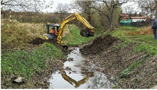
Abbildung 7 Sedimentberäumung im Mündungsbereich von Peterbach und Urbach in Erfurt-Linderbach
