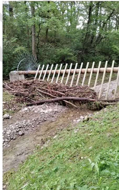
Abbildung 9 Notwendige Beseitigung von Schwemmgut am Totholzrechen in Erfurt - Tiefthal
