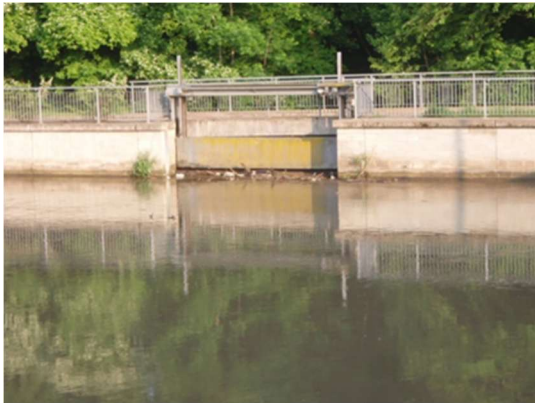
Abbildung 16 Notwendige Schwemmgutbeseitigung am Bergstromeinlauf
