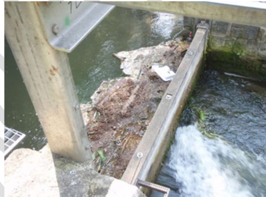
Abbildung 17 Schwemmgutbeseitigung am Kronenburgwehr in Erfurt
